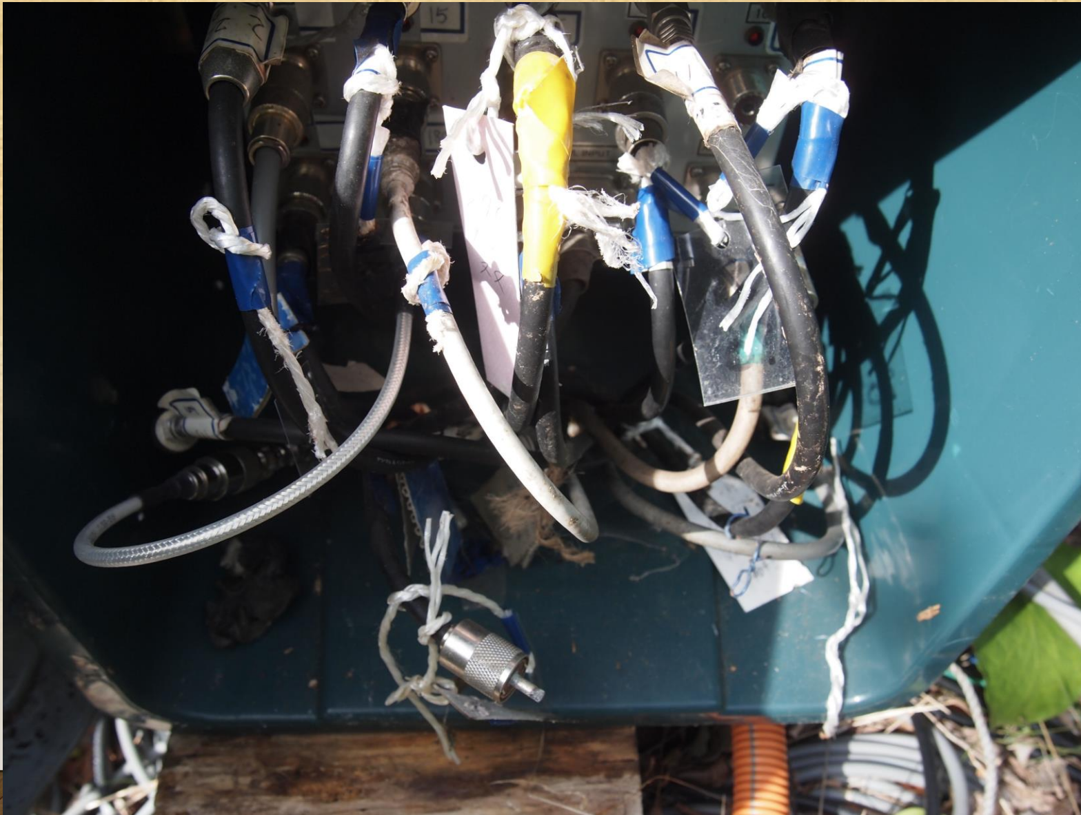
12本のビバレージアンテナ 切換リレーBOX (サガミエンジニアリング特注品)
